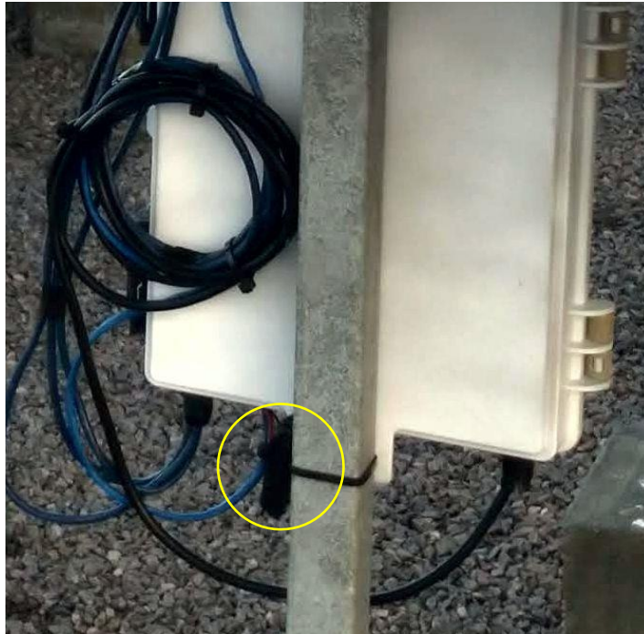
Figura 103: local de instalação do sensor DHT21.
