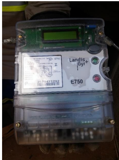
Figura 22 – Medidor bidirecional instalado na subestação da UFERSA.
