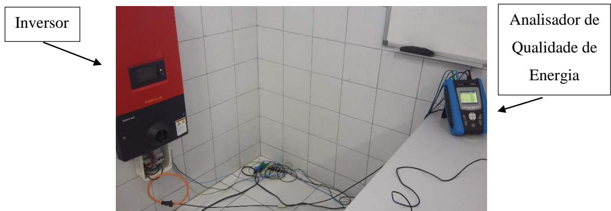
Figura 23 – Analisador de energia instalado na saída do inversor.
